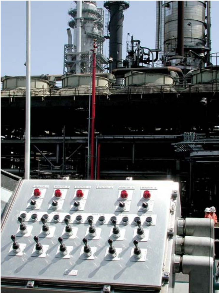
Painel de controle operando vários canhões
